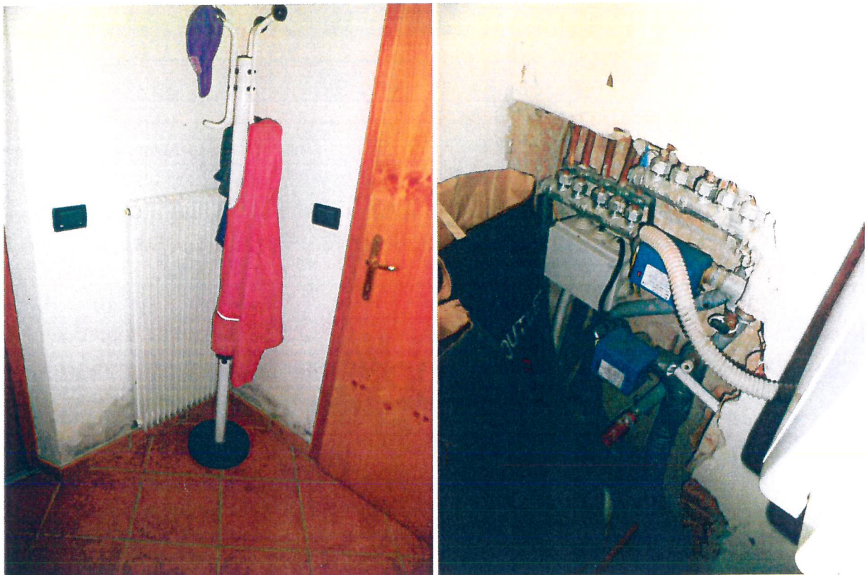
Fig. 8 – Radiatori dell'appartamento e collettore dell'impianto, sito al piano terra
