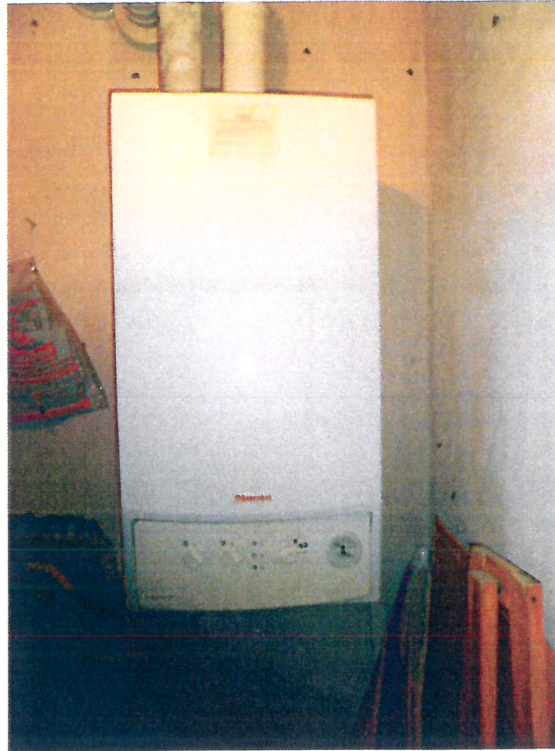
Fig. 7 – La caldaia dell'appartamento, sita nella parte vecchia al piano terra
