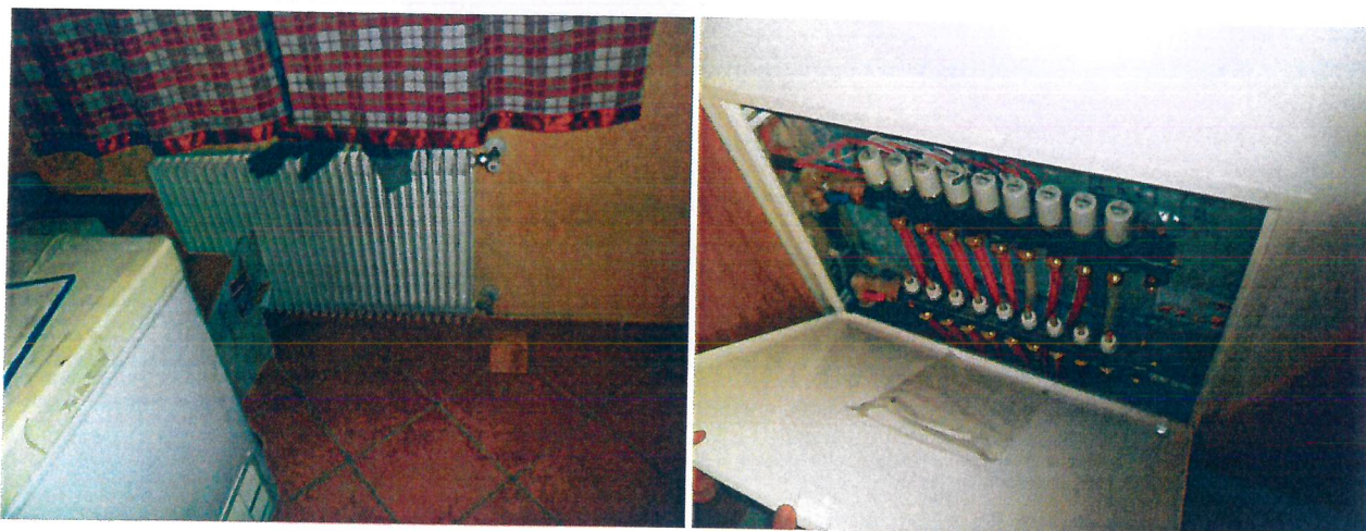
Fig. 6 – Radiatori della parte vecchia del Centro equestre e collettore dell'impianto a pavimento della parte nuova
